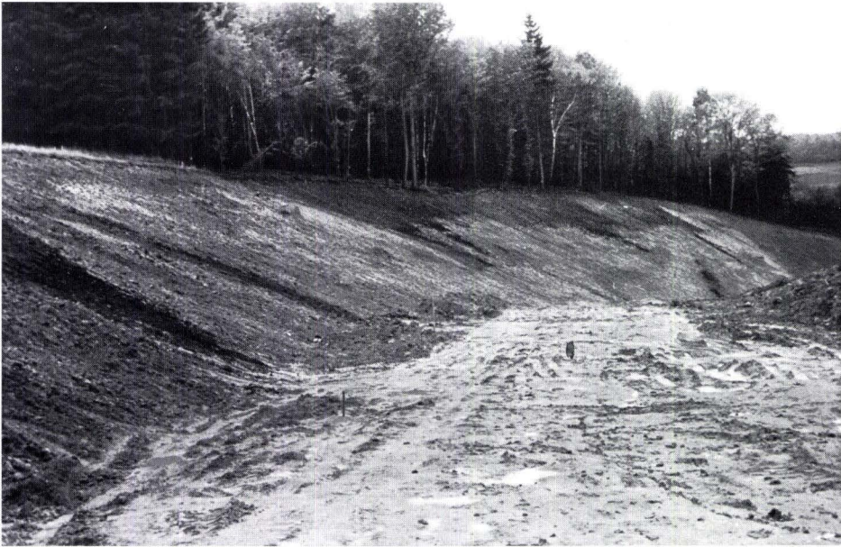
Abb.22. Gesamtansicht der Einbruchsstrukturen an der Kreisstraße 69 bei Mittelkalbach, Blick von NE nach SW.
