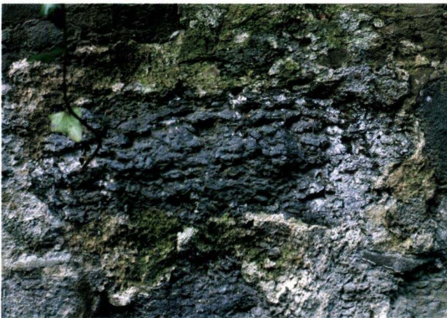
Abb. 18. Darmstadt, Mathildenhöhe, Umfassungsmauer: Rissbildung und Gefügeflockung im Melaphyr führt zu Bröckelzerfall mit Ausbrechen größerer Gesteinsfragmente.
