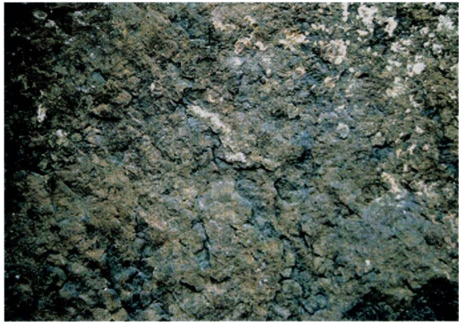
Abb. 20. Niederscheld, Privathaus: Pikrit-Mauerstein mit aufgeschuppter und verfärbter Oberfläche.
