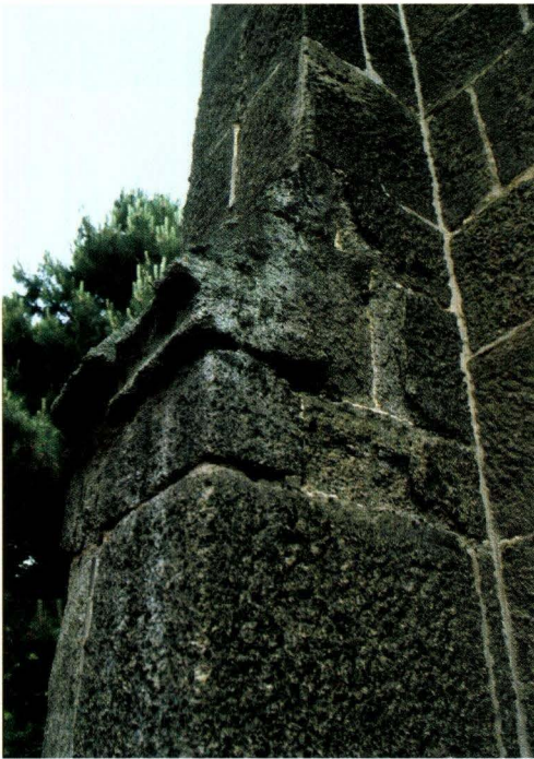
Abb. 12. Heckershausen evangelische Kirche: Rückwitterungen der Lapillituff-Mauersteine durch Absanden und Schalenbildung an exponiertem Strebeböfeler.
