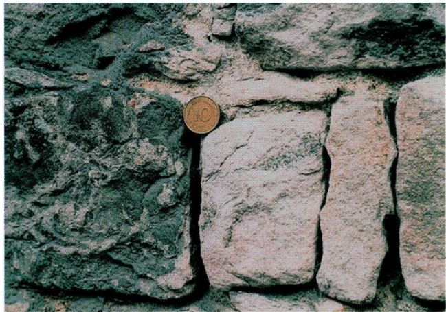
Abb. 21. Heusenstamm, Mauer an evangelischer Kirche: Anlagerung dunkler Krusten und Aufschuppungen an Dietzenbacher Trachytvarietät.
