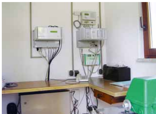
Abb. 12: Innenansicht Pegel Bad Soden.
