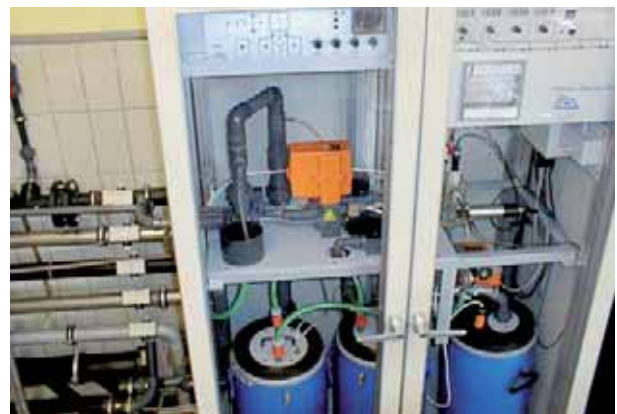
Abb. 22: Innenansicht Messstation Bischofsheim: Messschrank.
