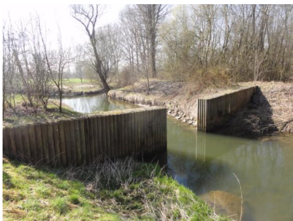
Abbildung 3.11: Drosselbauwerk des Retentionsraums Groß-Zimmern bei Mittelwasser, Quelle: BGS Wasser
