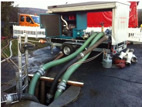
Pumpenschacht am 2,20m Kanal am "Vaaker Weg" beim Hochwasser 2012
