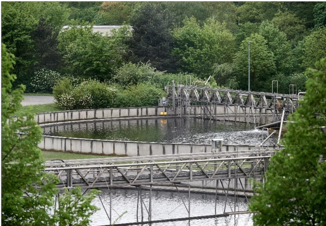
Abb. 23: Nachklärbecken des Zentralklärwerts Darmstadt (Foto: ENTEGA Abwasserreinigung GmbH & Co.KG)
