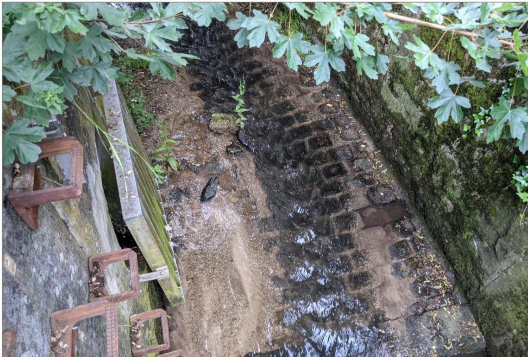
Abb. 5: Auslass einer Mischwasserentlastungsanlage (Foto: HLNUG, Wiesbaden)
