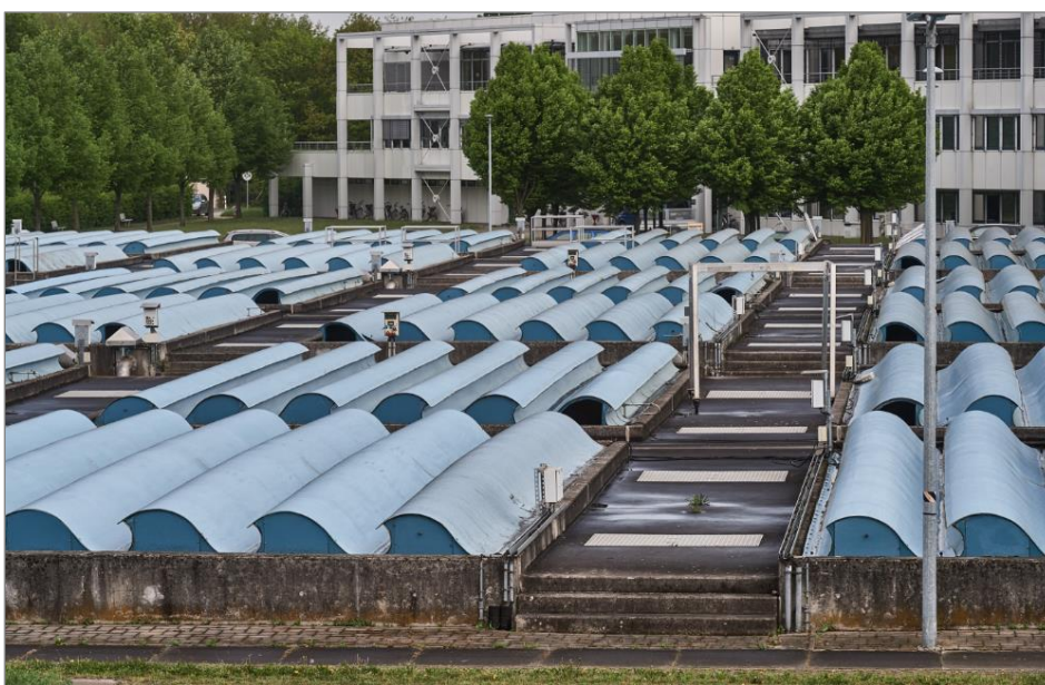
Abb. 1: Belebungsbecken mit Betriebsgebäude des Zentralkläwerks Darmstadt (Foto: ENTEGA Abwasserreinigung GmbH & Co.KG).
