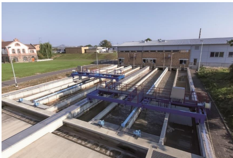
Abb. 1: Sand- und Fettabscheider des Klärwerks Gießen (Foto: MWB – Mittelhessische Wasserbetriebe).
