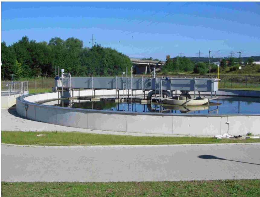
Abb. 24: Nachklärbecken (Foto: Stadtwerke Hünfeld).
