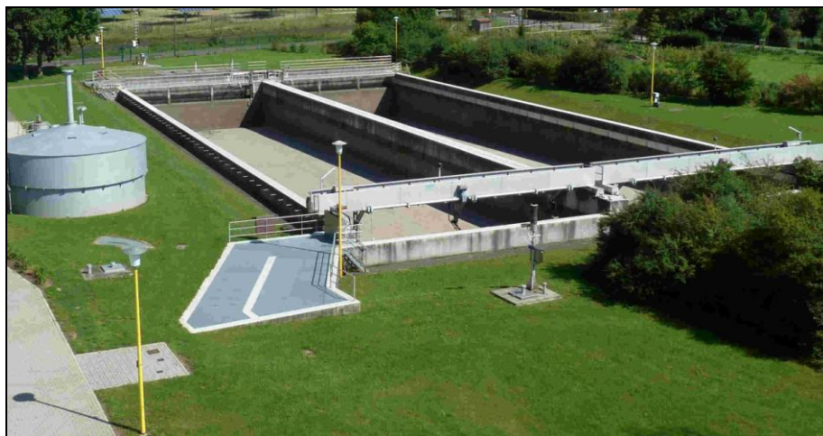
Abb. 4: Regenrückhaltebecken Kläranlage Hünfeld (Foto: Stadtwerke Hünfeld).
