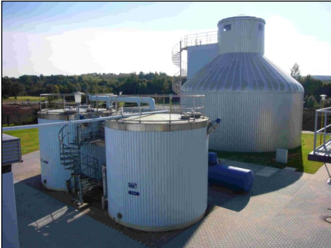
Abb. 25: Faulbehälter (Foto: Stadtwerke Hünfeld).
