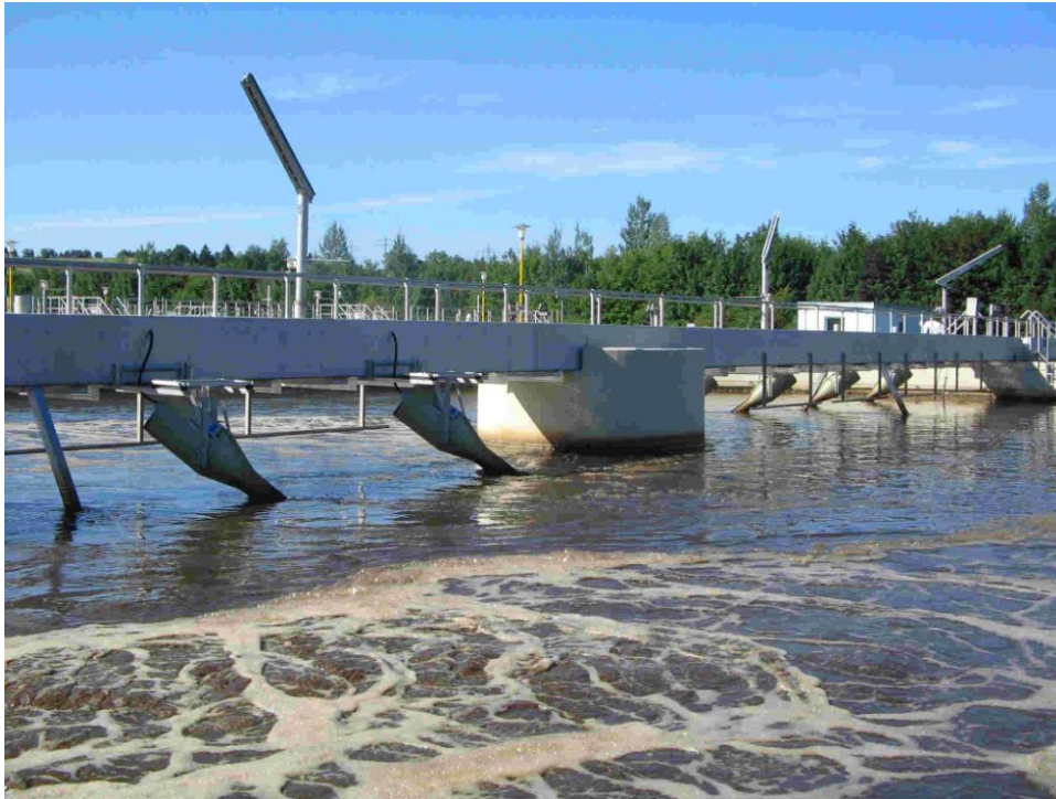
Abb. 13: Belebungsbecken (Foto: Stadtwerke Hünfeld).
