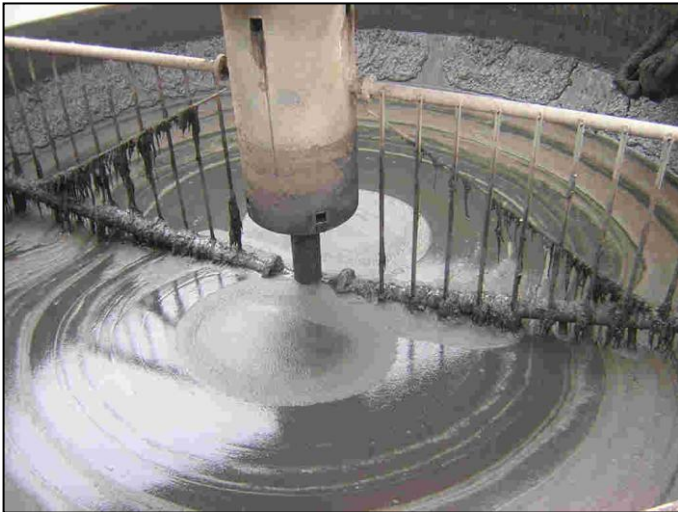
Abb. 26: Faulschlammbehandlung (Foto: AV Wetzlar).
