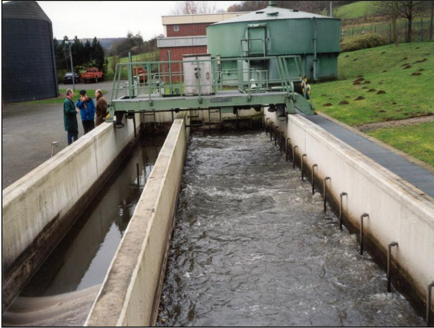
Abb. 30: Sandfang Kläranlage Nidda (Foto: eigene Quelle).
