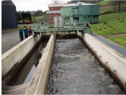
Abb. 23: Sandfang der Kläranlage Nidda
