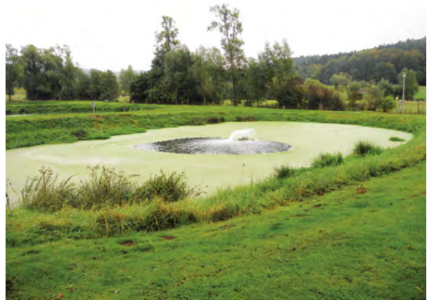
Abb. 12: Im Schönungsteich installierter Oberflächenbelüfter mit Tauchmotor und pilzförmigem Wasserauswurf
