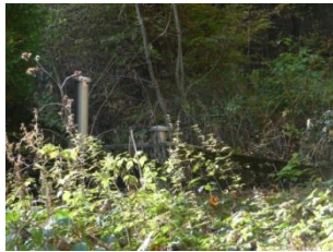
Quellfassung ohne Einzäunung der Zone I
