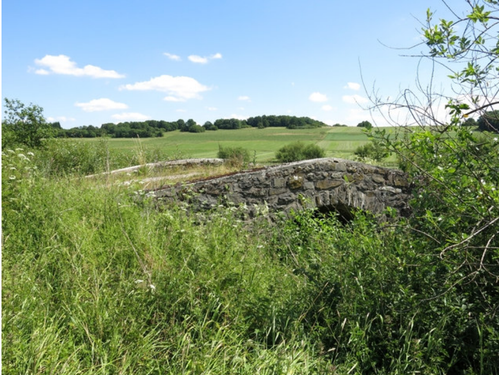
Abbildung 14: Stark mit Gehölzen zugewachsenes Gewässerufer an der Disseler Brücke.
