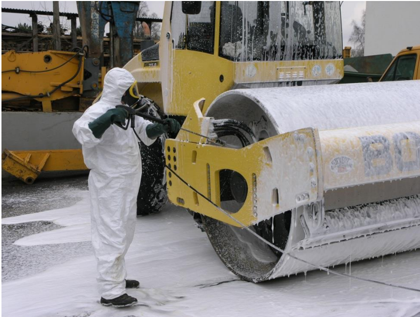
Abbildung 7: Desinfektion einer GPS-gesteuerten Walze vor dem Einsatz auf der Baustelle im Steinkrebsgebiet, nach gründlicher Vorreinigung mit Dampfstrahler (Photo: R. Hennings, 2.3.2009, P3022766)
