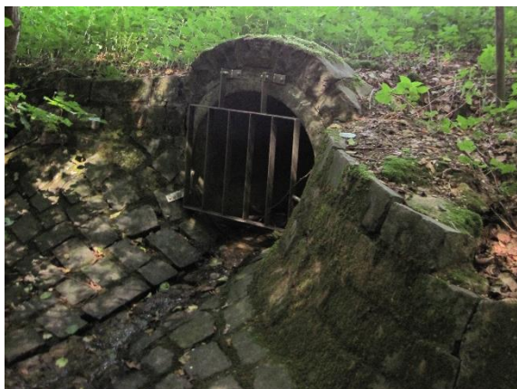
Abbildung 12 mögliche Gefährdung durch Überlaufrohr an der KA Auringen (PS w3)
