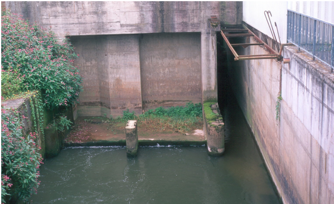
Abb. 6.3: Turbinenauslauf der Wasserkraftanlage Sielen im Unterlauf der Diemel
