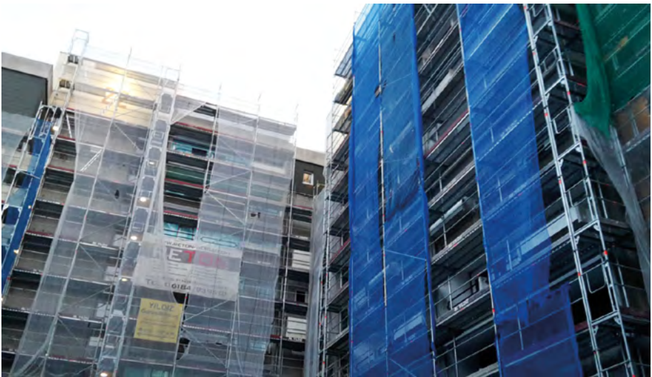
Abb. 53: Die im Zuge der Energiewende notwendige Sanierung und Dämmung von Gebäuden kann zum Verlust von Fledermausquartieren oder gar zum Einschluss ganzer Kolonien führen, sofern im Vorfeld keine ausreichende artenschutzrechtliche Kontrolle erfolgt © Markus Dietz
