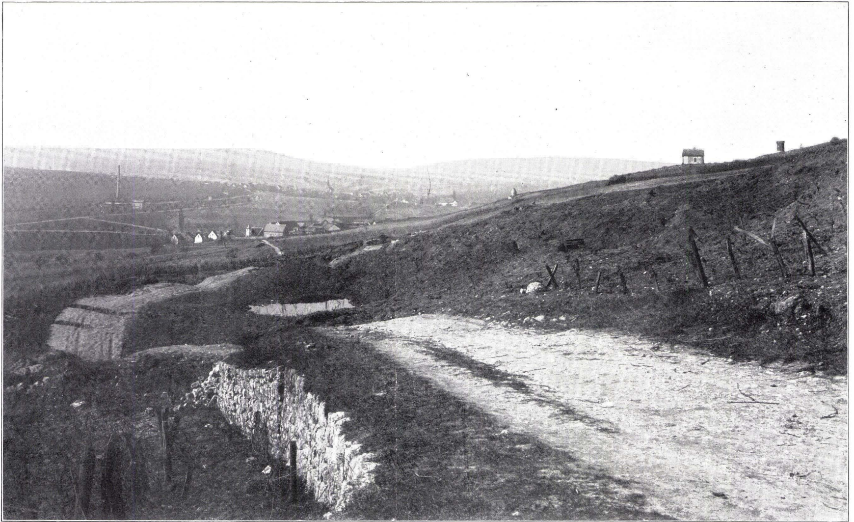
Rutschung westlich von Mölsheim. Der verdrückte Weg nach Niefernheim und eine mit Wasser gefüllte Wanne.
