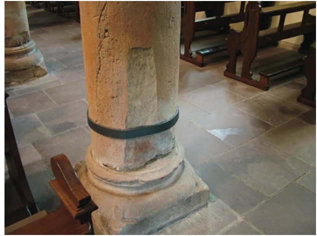
Abb. 14: Westliche Säule aus der südlichen Langhausarkade der Pfarrkirche von Rasdorf (Die rötliche Färbung wird von Resten einer ehemaligen Bemalung erzeugt. In der Abplatzung ist die eigentliche grau- weiße Farbe des Sandsteins zu erkennen).
