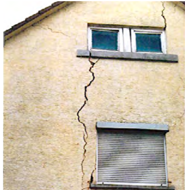
Abb. 5: Gebäudeschaden in Form von Rissen durch Setzungen des Untergrundes
