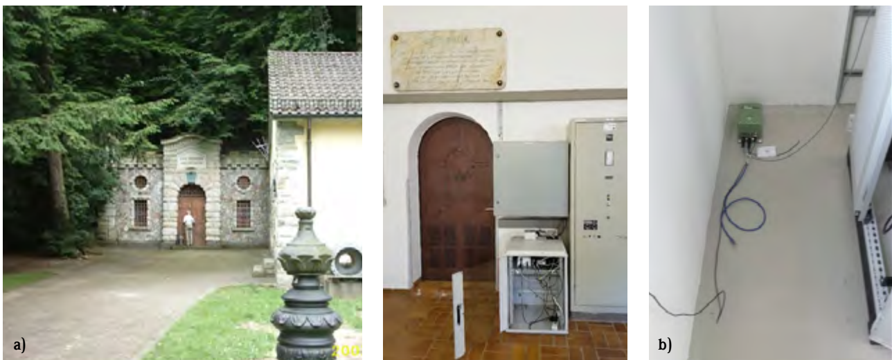
Abb. 5: Beispiele für Erdbebenmessstationen des HED im Ballungsraum Rhein-Main a) Kreuzstollen in Wiesbaden – Messstation GWBE b) Strong Motion Messstation WBFM – Senckenberg-Museum Frankfurt
