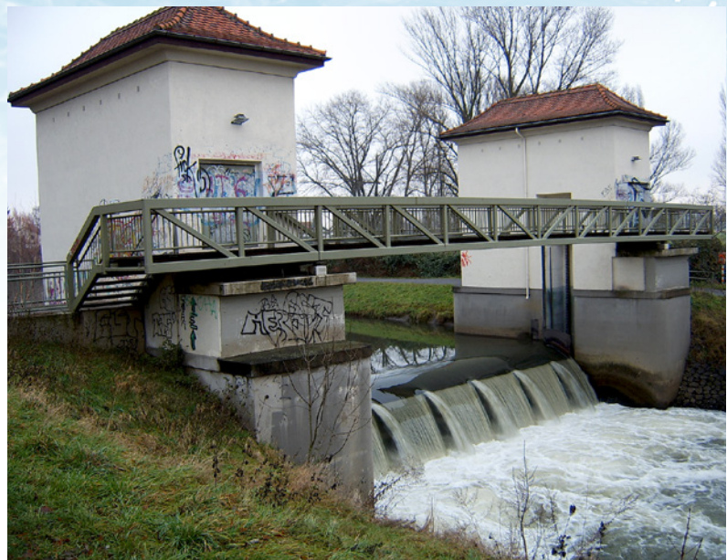
Abb. 1: Höchster Wehr vor dessen Rückbau. Das Wehr war für Fische weder stromaufwärts noch -abwärts passierbar.
