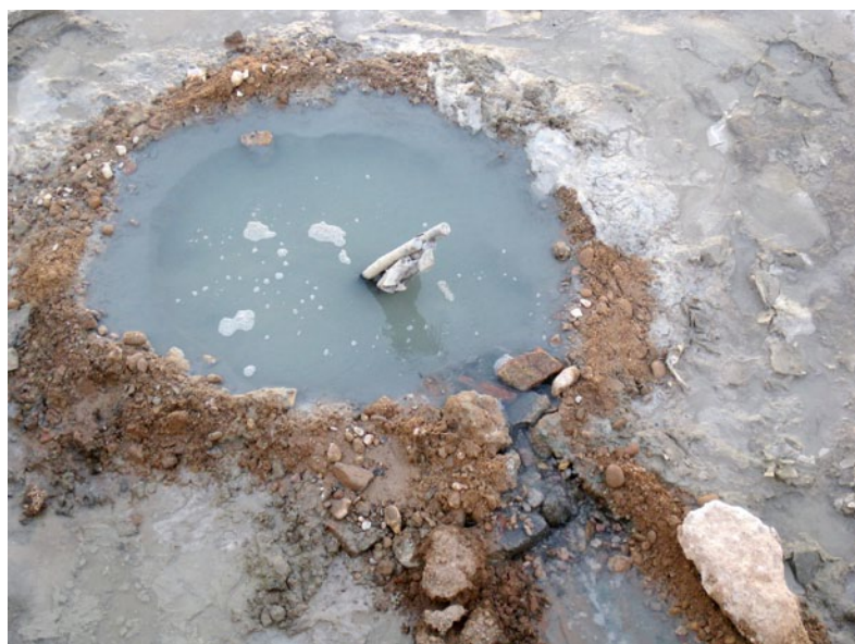
Abb. 3: Aus einer Erdwärmesondenbohrung wegen mangelnder Abdichtung austretendes Wasser.
