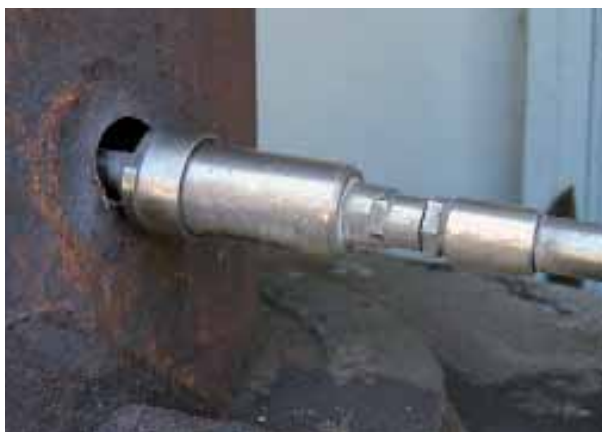
Abb. 5: Sonde mit Staubfilter am Kamin des gasgefeuerten Kessels.
