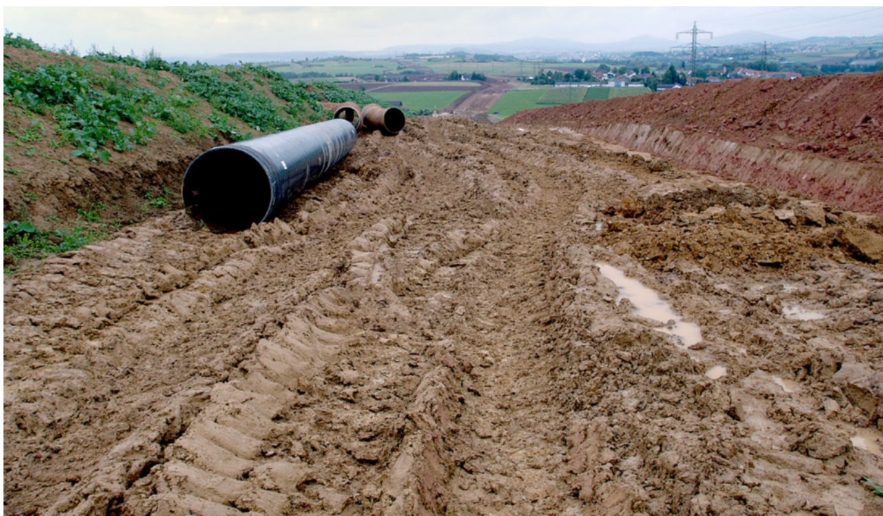
Abb. 14: Durch Verdichtung in den Fahrspuren kann Wasser nicht versickern. Dies betrifft nicht nur Baustellen, sondern auch Ackerflächen und Rückgassen im Wald.
