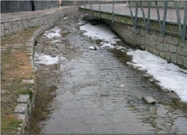
Abb. 14: Gewässer ökologischer Zustandsklasse 5: strukturelle Degradation bedingt schlechte Biologie, keine chemische Belastung. (Foto GOBIO GmbH)
