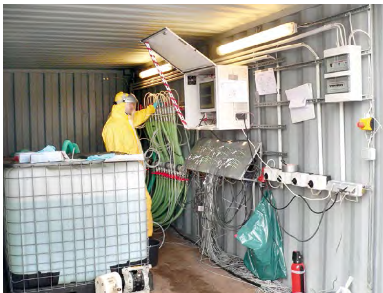
Abb. 4: Anlagencontainer ISCO Oberfranken.
