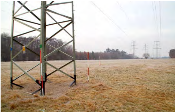
Abb. 3: Vorbereitung der Probenahme an einem belasteten Maststandort. Die Vermessungsstäbe zeigen, wie kleinräumig die potenziell belastete Fläche ist.
