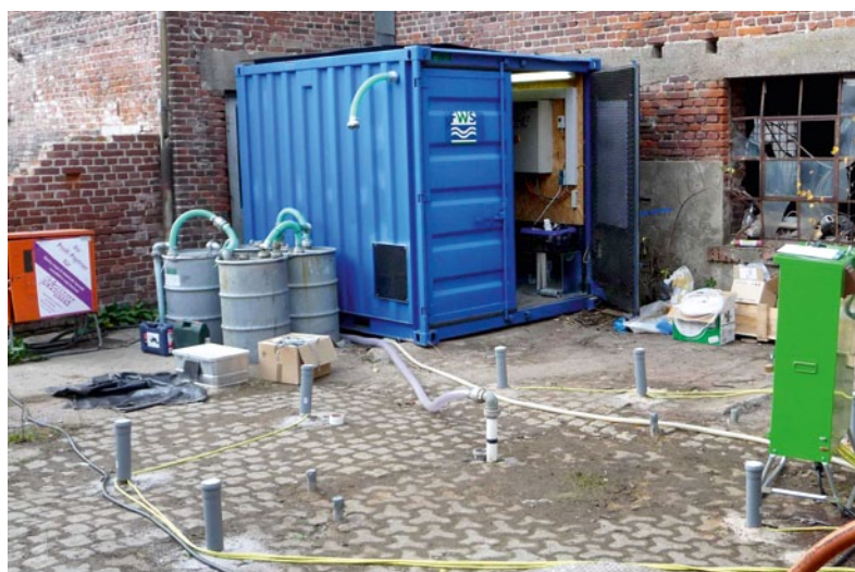
Abb. 2: Die THERIS-Versuchsanlage im Hof der Fa. Berninger, in der Mitte BL 1 (Foto: M. Wolf).
