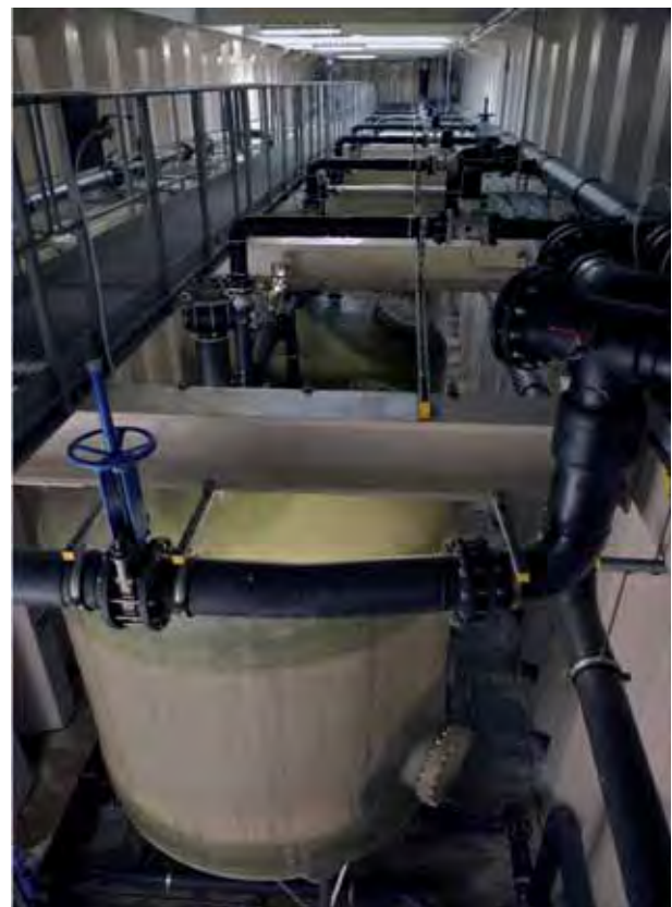
Abb. 8: Anlagentechnik Gate I (Quelle: bfm GmbH).
