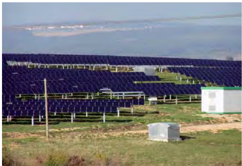
Abb. 3: Photovoltaikanlage. Die Photovoltaikanlage wurde auf einer Fläche von rund 18 000 m 2 errichtet. Die Dünnschichtmodule verfügen über eine elektrische Leistung von 445 kWp.
