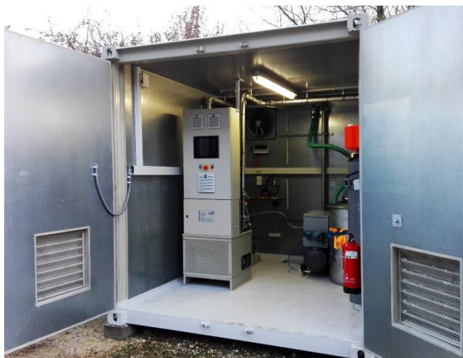
Abb. 5: Anlagentechnik zur Einzelpegelansteuerung vor Ort
